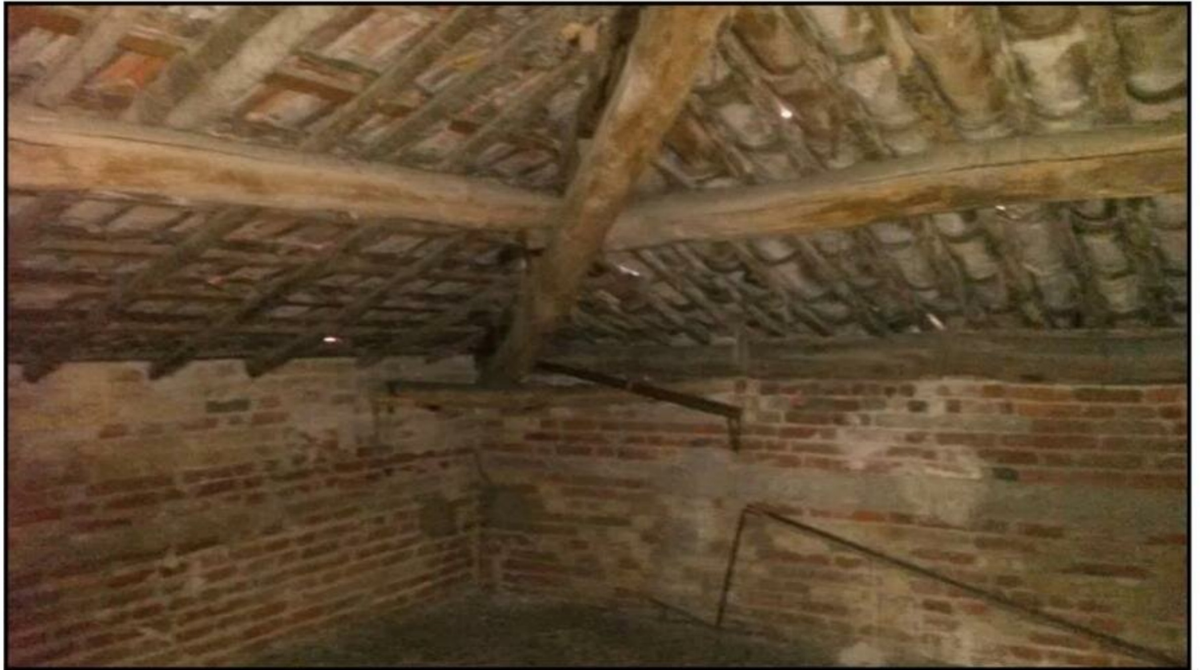
Mancanza di presidi a contenimento della spinta per il puntone di displuvio tra falde adiacenti
