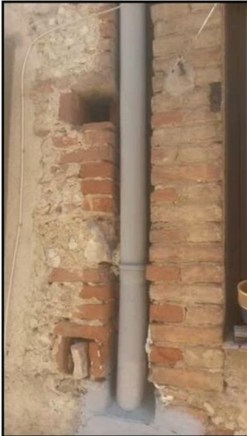
Presenza di scarichi nello spessore del pannello murario
